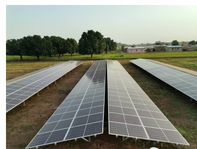
Mali: Ländliche Elektrifizierung
